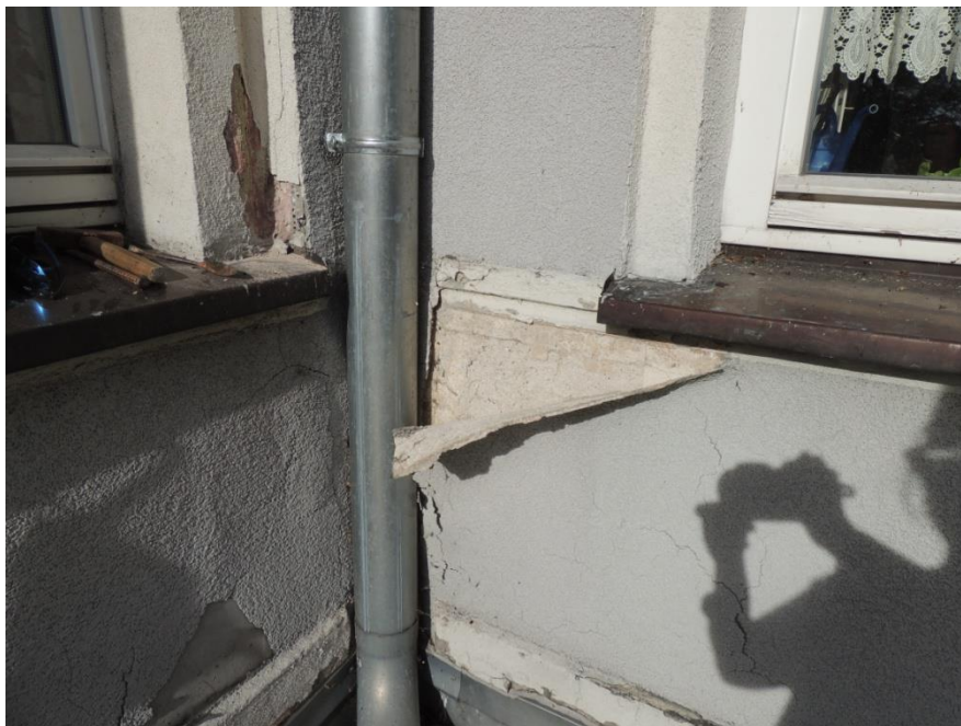
13. Zniszczone tynki pod warstwą tynku polimerowego.
