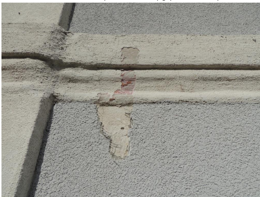
16. Zatarte kształty gzymsu naściennego.
