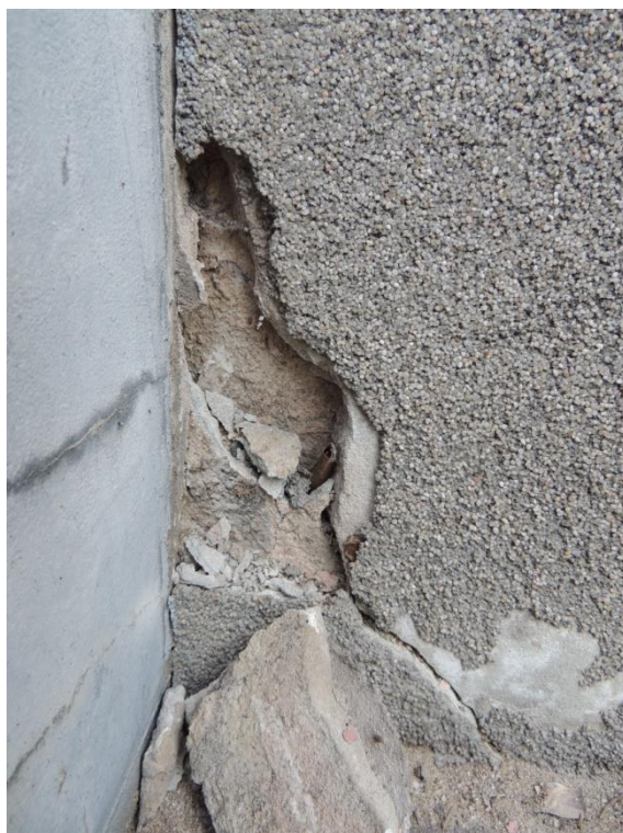
17. Zniszczone tynki pod warstwą tynku polimerowego.
